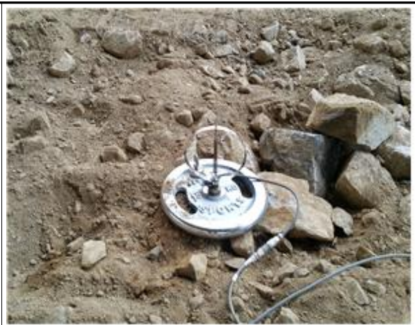
처짐계 설치 현황
