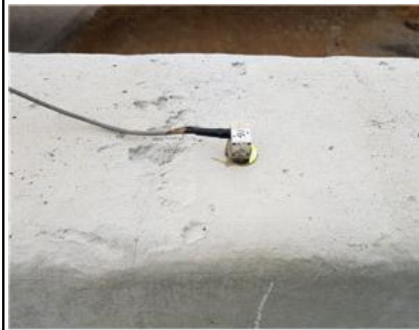
가속도계 설치 현황
