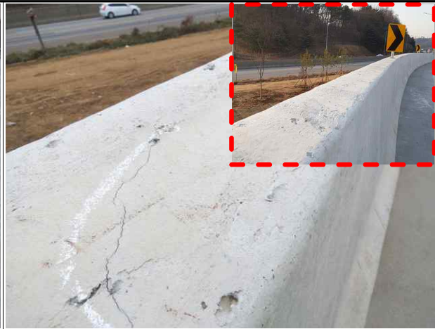
방호벽 균열(폭 0.3mm미만)(보수완료)
